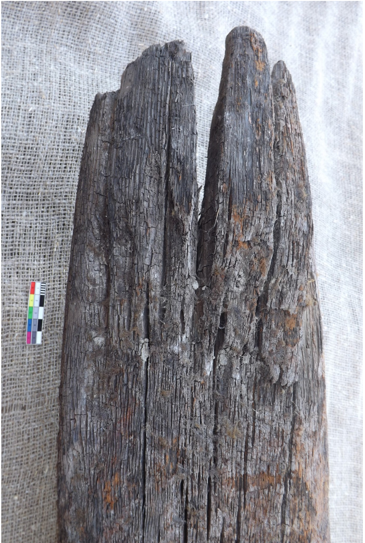
Рисунок 7. Пошкодження нижньої частини балки
