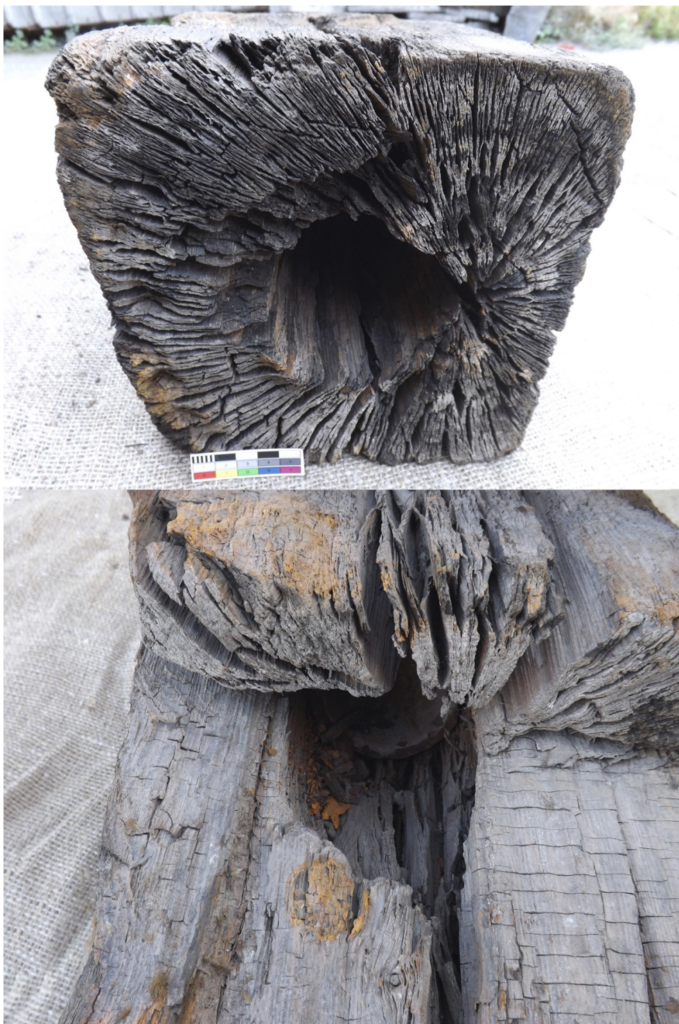
Рисунок 6. Пошкодження торцевої частини балки
